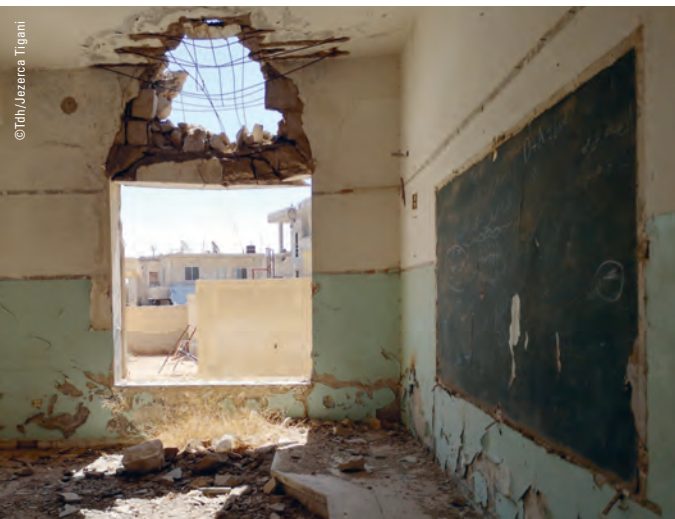
Eine zerstörte Schule in Modamyet el Sham.
